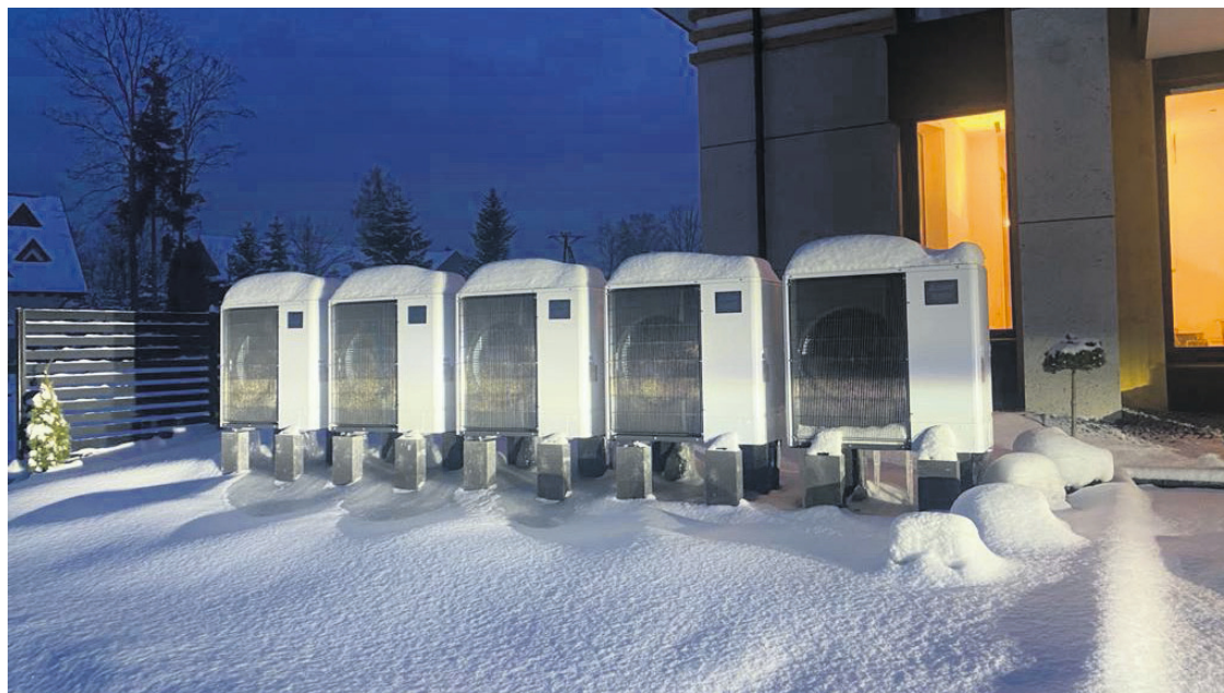
• W Skandynawii obecnie najczęściej montowanym źródłem ciepła jest właśnie powietrzna pompa ciepła FOT. MITSUBISHI
