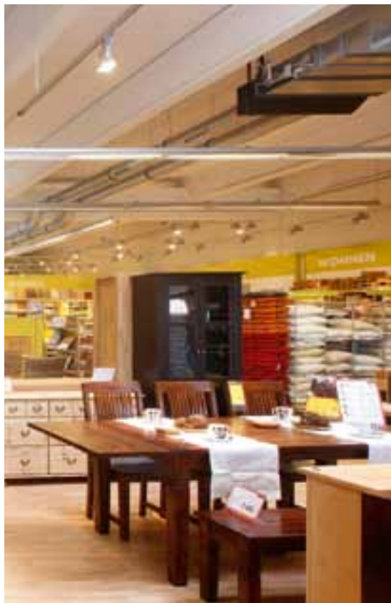
Vier Kanaleinbaugeräte sorgen für ein gleichmäßig angenehmes Temperaturniveau. Four Ceiling concealed units ensure a consistently pleasant temperature.
