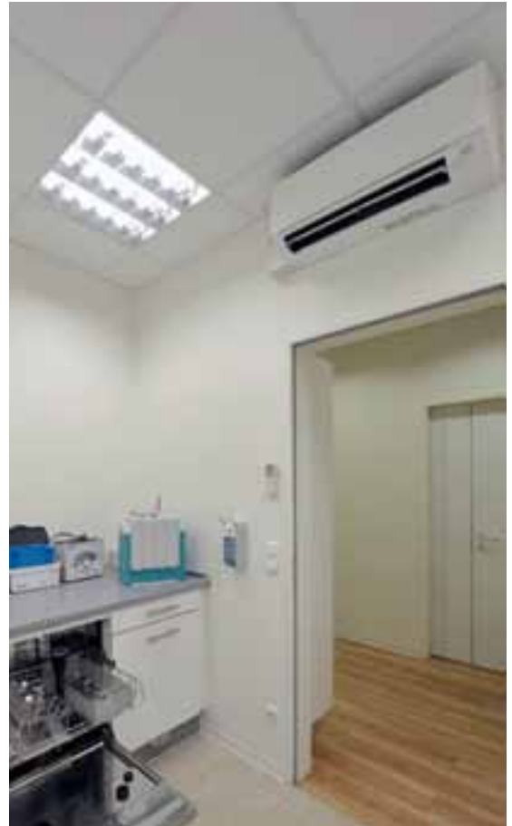
Im Sterilisationsraum sorgt jetzt ein Wandgerät aus der M-Serie für angenehme Arbeitstemperaturen. A M-Series wall mounted unit now ensures a pleasant temperature while staff work in the sterilisation room.
