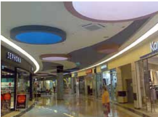
Neben Kanaleinbaugeräten wurden 4-Wege-Deckenkassetten im Mall-Bereich eingesetzt. In addition to ceiling concealed units, 4-way ceiling cassette were used in the Mall.
