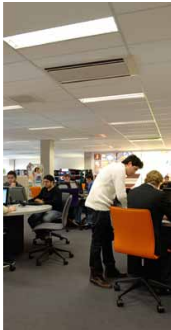
Kühlen und heizen – für ein angenehmes Arbeitsklima. Im ROC kommt modernste Klimatechnik von Mitsubishi Electric zum Einsatz. Cooling and heating for a pleasant work environment. State-of-the-art Mitsubishi Electric air conditioning technology is used at ROC.
