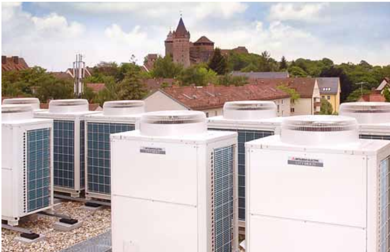
Die elf leistungsstarken City Multi VRF-Außengeräte sind auf dem Dach des Objekts untergebracht – und somit höchstens von der Nürnberger Burg aus mit dem Fernrohr sichtbar. The eleven high-capacity City Multi VRF outdoor units are housed on the roof of the building and thus can only be seen, if at all, using a telescope from the nearby Nuremberg castle.
