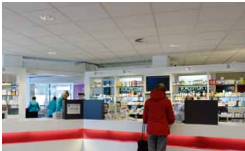
Die 31 Kanaleinbaugeräte gehören mit einem Schalldruckpegel von 23 dB(A) zu den leisesten ihrer Art. With a noise level of only 23 dB(A), the 31 ceiling concealed units are among the quietest of their type.
