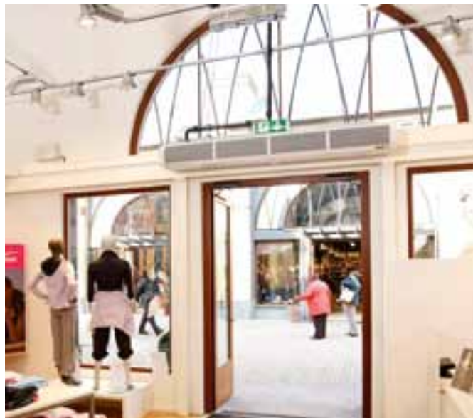
Die Technologie des Türluftschleiers am Eingang sorgt dafür, dass kalte Luft draußen bleibt, selbst bei geöffneten Türen. The air curtain system at the entrance ensures that cold air remains outside, even at open doors.
