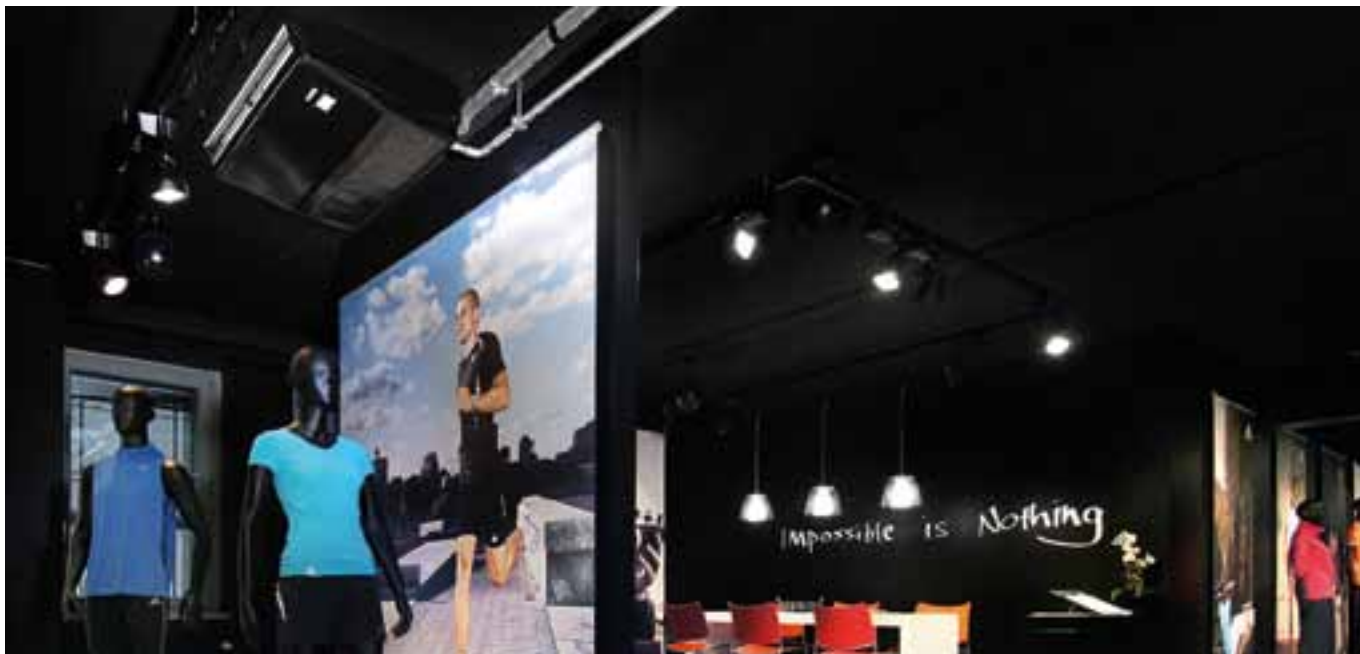
Die Deckenunterbaugeräte wurden auf Wunsch speziell schwarz lackiert und fügen sich somit nahezu unsichtbar in das Raumkonzept ein. The ceiling suspended units were given a special black finish as requested, thus fitting very discreetly into the design concept of the space.
