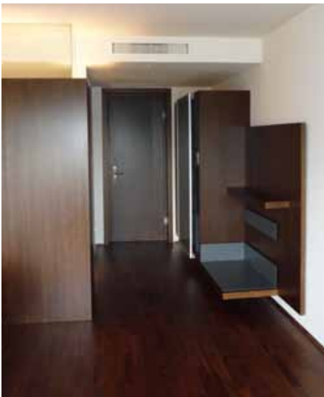
Die 90 Zimmer im Hotel Penz West wurden nachträglich mit flachen, flüsterleisen Kanaleinbaugeräten versehen. Bedient werden die Anlagen zentral über eine G-50 Steuerung. The 90 rooms at the Hotel Penz were retrofitted with flat, whisper-quiet ceiling concealed units. The system is operated centrally via a G-50 controller.
