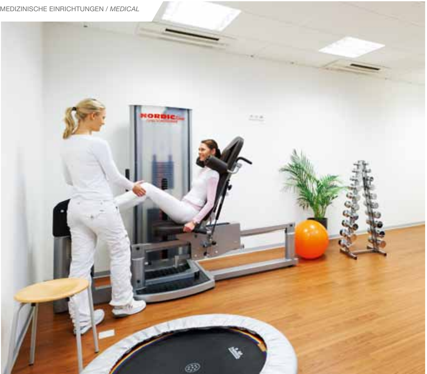
1-Wege-Deckenkassetten sorgen in den Sporträumen für zugluftfreie und angenehme Temperaturen. One-way ceiling cassettes ensure pleasant, draught-free temperatures in the exercise rooms.
