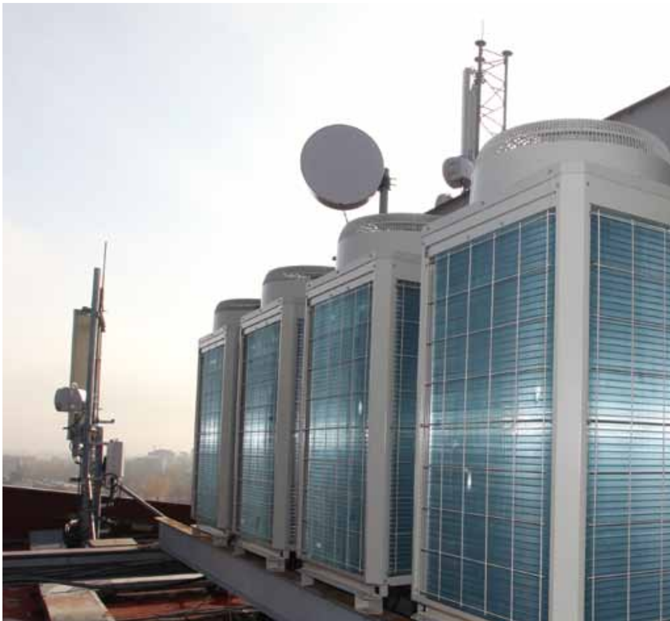
Insgesamt wurden acht Außengeräte durch neue Replace Multi VRF-Geräte modernisiert, die mit dem Kältemittel R 410A befüllt sind. A total of eight outdoor units from the Replace Multi VRF-units were installed, which use the refrigerant R410A.
