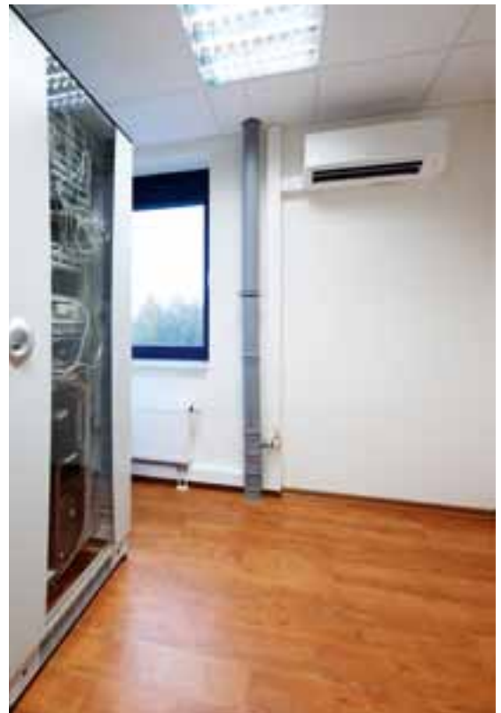
Der Serverraum wird extra über ein weiteres Split-Klimagerät separat gekühlt. The server room is cooled separately using an additional split air conditioner.
