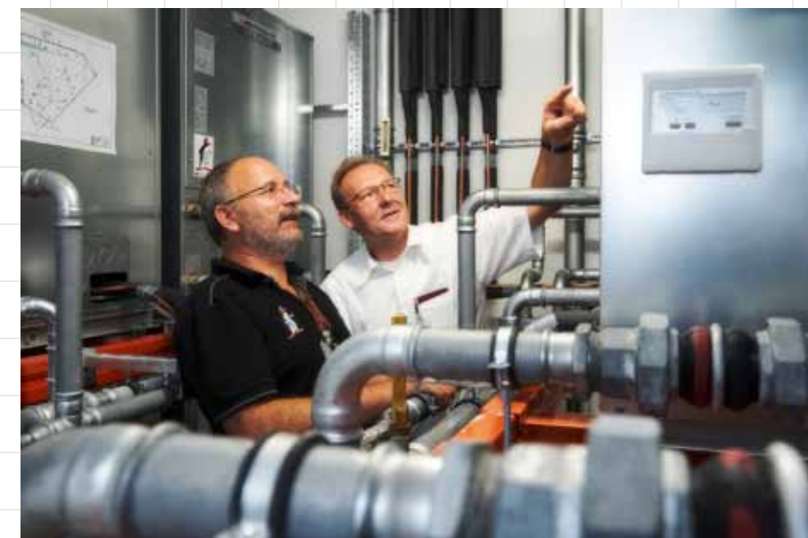
Rolf Wiesinger (li.), Geschäftsführer W+W Kälte- und Klimatechnik GmbH und Thomas Schmidt (re.), Regionalleiter Frankfurt Mitsubishi Electric, bei einer Funktionsprüfung der ersten betriebsfertigen Anlage.
