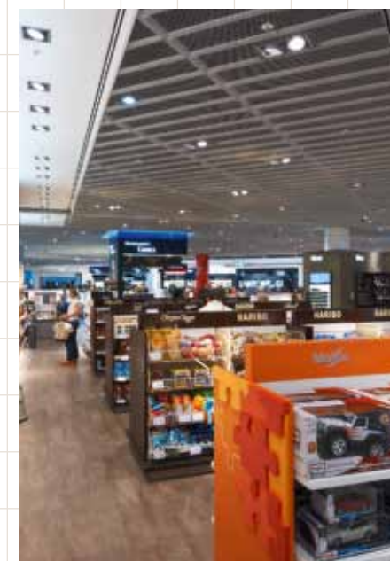
Über Schlitzschienen wird die konditionierte Luft zugluftfrei in die Verkaufsräume eingeblasen.
