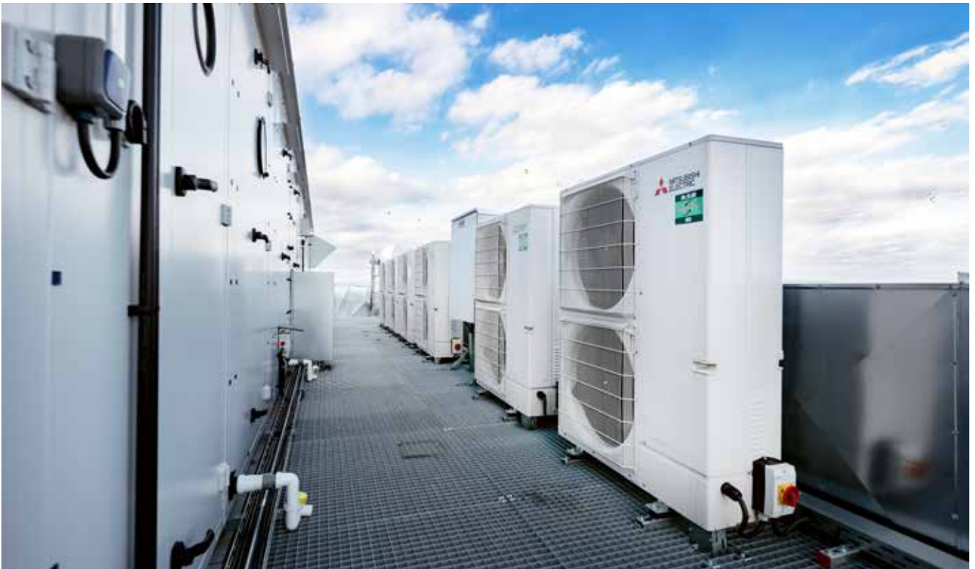
Zur Konditionierung der Frischluft kommen Mr. Slim-Außengeräte mit Wärmepumpenfunktion als Sechser-Kaskade zum Einsatz.
