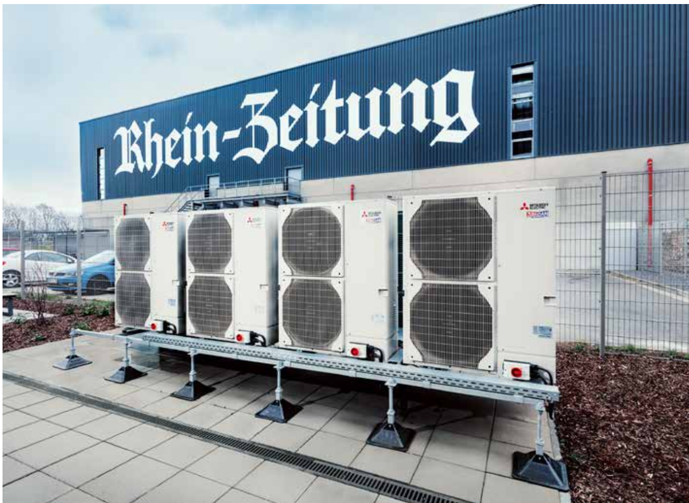
Für die Fußbodenheizung kommen acht reversible Ecodan Luft/Wasser-Wärmepumpen von Mitsubishi Electric mit einer modulierenden Heizleistung von bis zu 184 kW zum Einsatz.
