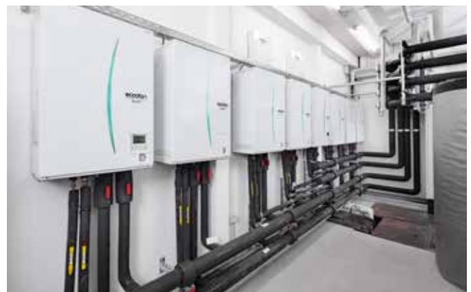
In den Inneneinheiten, den sogenannten Hydromodulen, wird die Wärmeenergie vom Kältemittel auf das Brauchwasser übertragen.
