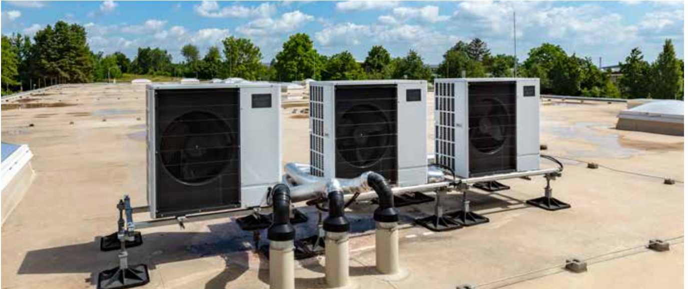
Für die Beheizung und Kühlung des nach KfW-Energie-Standards gedämmten Gebäudes kommen drei Luft/Wasser-Wärmepumpen von Mitsubishi Electric als Kaskade zum Einsatz.
