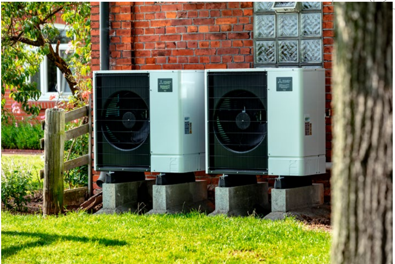
Zum Einsatz kommen zwei kompakte Ecodan Luft/Wasser-Wärmepumpen von Mitsubishi Electric, die als Kaskade im Außenbereich installiert worden sind.
