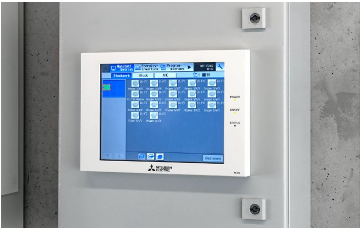
Auf jedem Stockwerk besteht Zugriff über das visuelle Zentralsteuerungssystem vom Typ AE200. Das Steuerungssystem erleichtert die Überwachung und Statusanzeige von einem zentralen Punkt aus.
