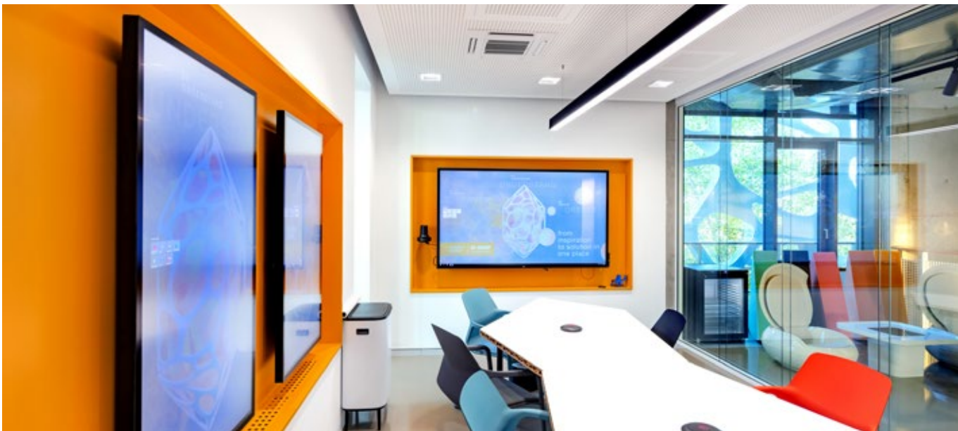
Jeder Bereich kann individuell beheizt oder gekühlt werden. Das innovative Hybrid VRF-System zeichnet sich durch eine hohe Energieeffizienz aus.
