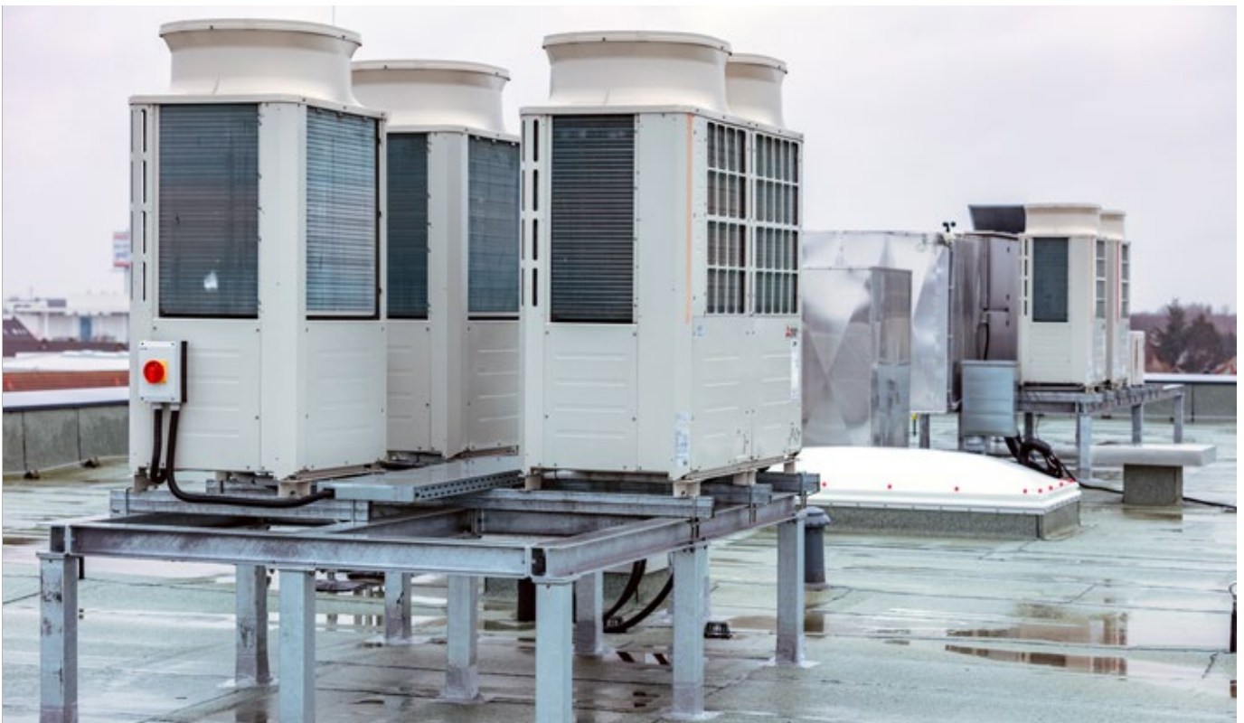
Sechs Hybrid VRF-Außengeräte mit 400 kW Kälte- und 450 kW Heizleistung sind auf einem Dach aufgestellt. Sie führen das Kältemittel über Strangleitungen zu sechs HBC-Controllern.
