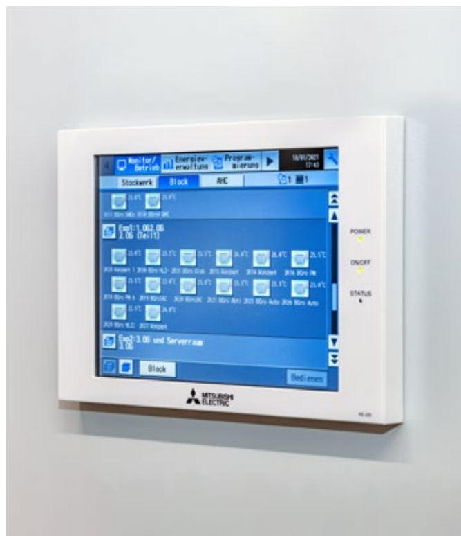
Die Steuerung der Klimatechnik wird über das Remote Monitoring Interface (RMI) von Mitsubishi Electric realisiert. Das Cloudsystem ermöglicht die zentrale Anlagenverwaltung des Klimasystems per Fernzugriff.
