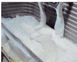
Eisbildung am Außengerät ohne Wannenheizung
