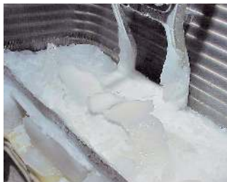
Eisbildung am Außengerät ohne Wannenheizung
