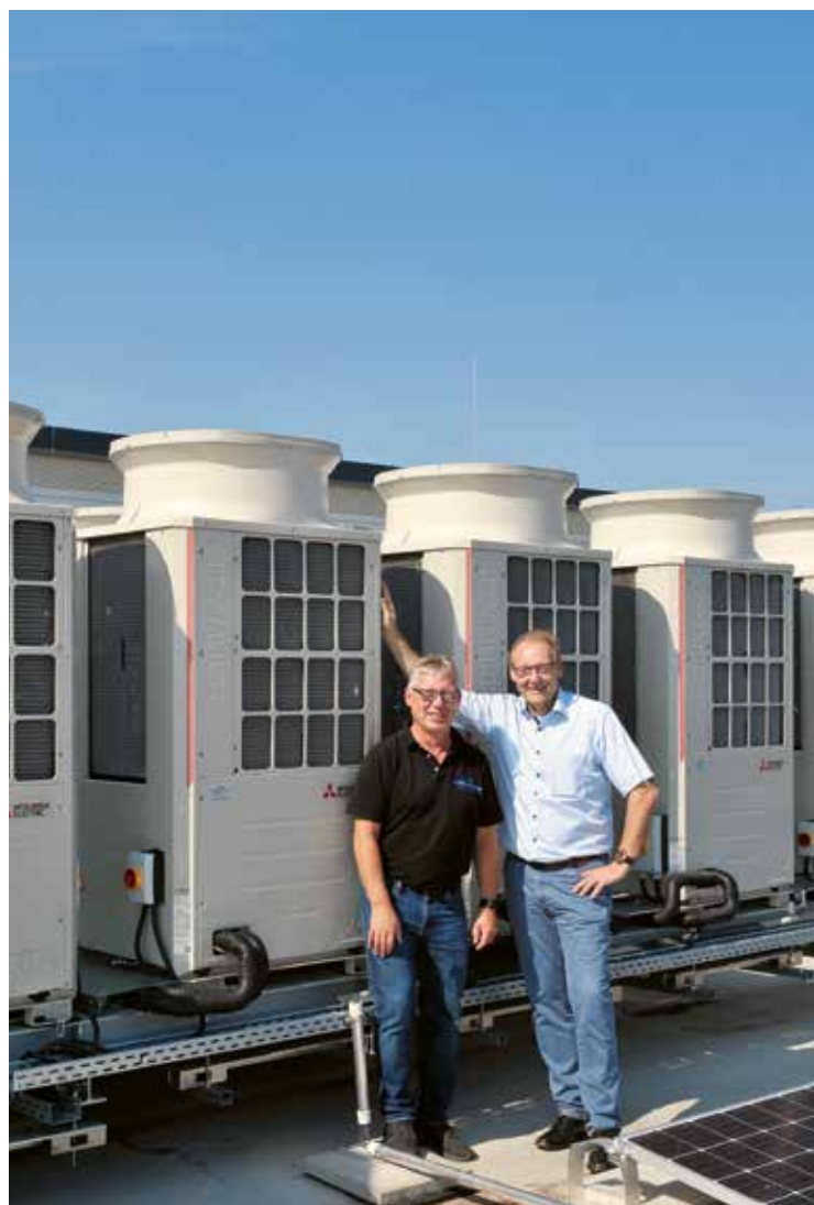
Die Außengeräte des Hybrid City Multi-Systems (Hybrid VRF) befinden sich auf dem Dach des Gebäudes. Frank Eisenstein (l.), Thomas Schmidt (r.).
